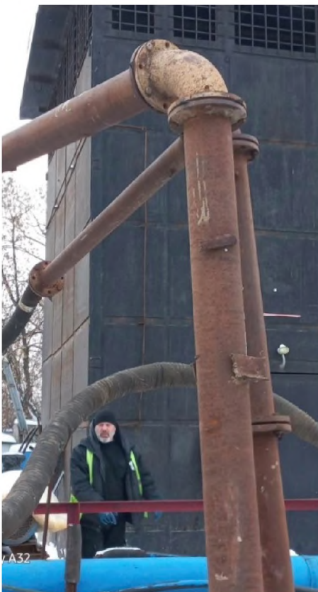
Рис. 8. Фрагменты котлована с коллектором (синим цветом) и подсоединенными к нему трубами скважинного и иглофильтового водопонижения
