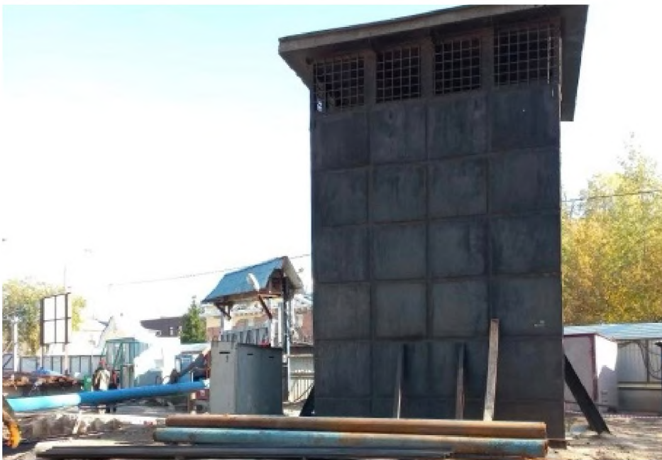
Рис. 1. Временный вентиляционный воздухозаборный киоск над стволом № 1237
