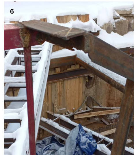
Рис. 6. Мосты с подвешенными коммуникациями: а – на начальном этапе разработки котлована на II этапе (лето 2023 г.); б – вид на пересечение стены котлована с деревянной забиркой на участке стены без крепления БСС (декабрь 2023 г.)
