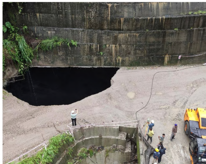
Первоначальный провал в районе входного участка ДТ-2
