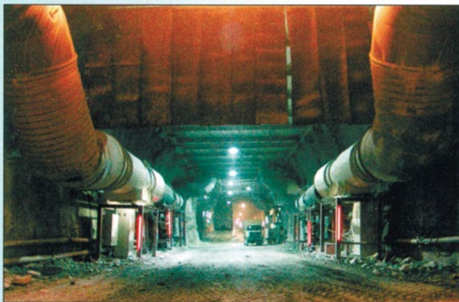
Рис. 38. Вентиляционные установки в Файло
