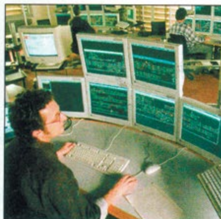
Рис. 48. Центр управления тоннеля и кабина машиниста
