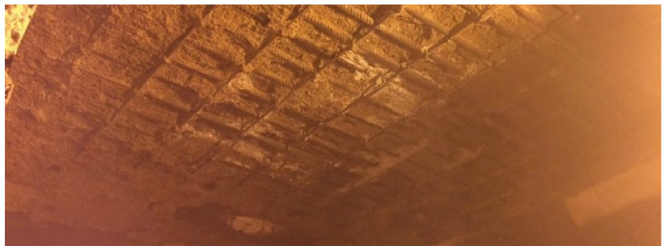
Рис. 1. Разрушение бетона в результате пожара в строящейся переходной камере Московского метрополитена, январь 2019 г.
