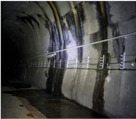
Рис. 3. Водопроявления в средней части тоннеля в зимний период
