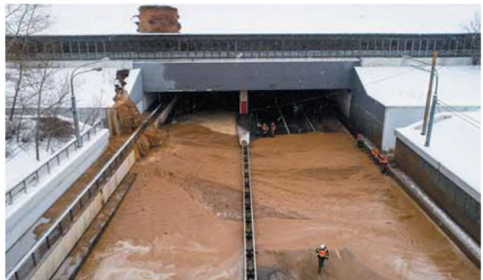
Рис. 3. Последствия разрушения глиняного замка канала им. Москвы с затоплением участка Волоколамского тоннеля
