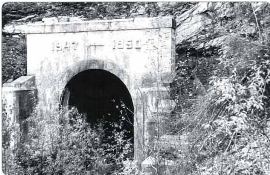
Рис. 4. Заброшенный портал Дуссе-Алинского тоннеля
