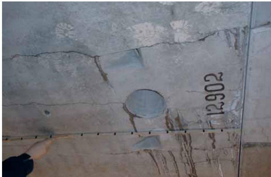
Рис. 5. Трещины в обделке из-за повышенных проходческих усилий
