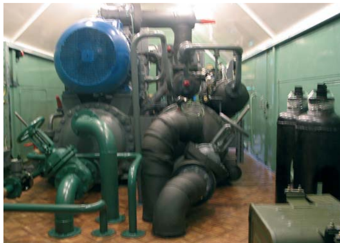
Внутреннее устройство замораживающей установки
