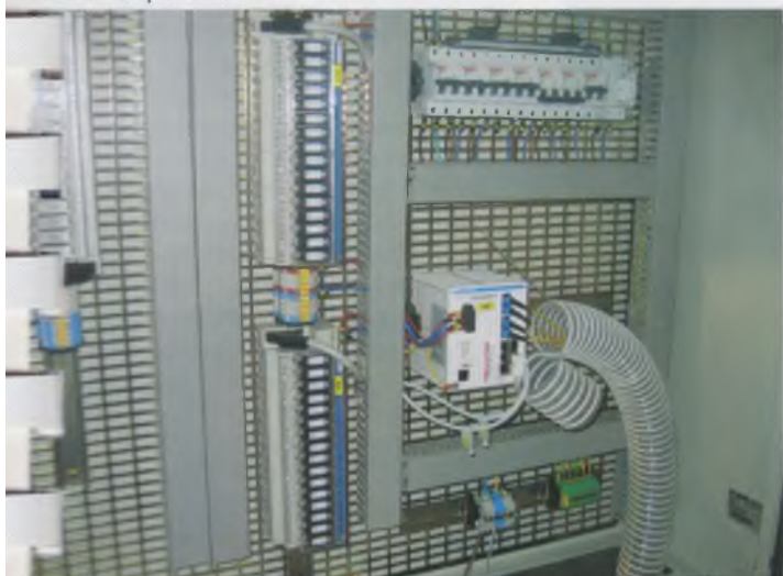
Рис. 3. Шкаф АСУ ТП
