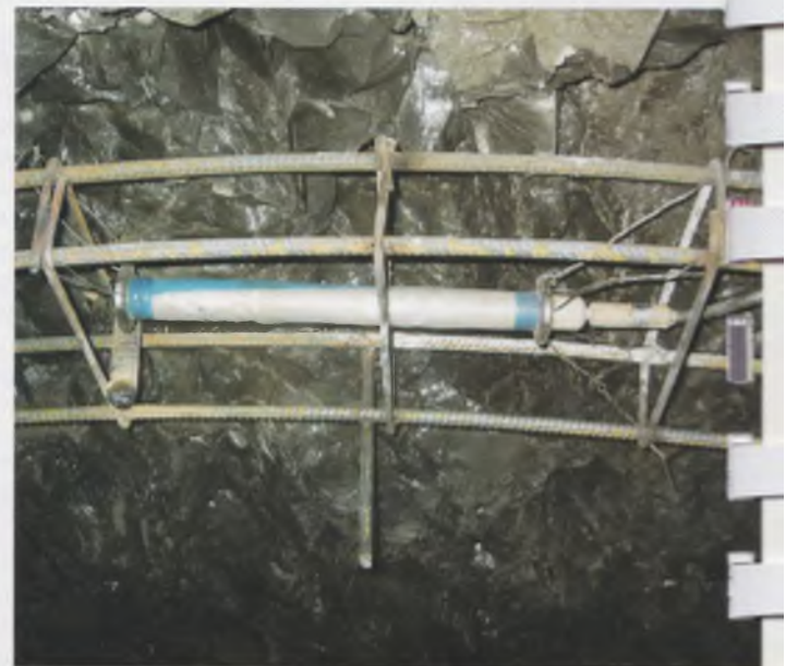
Рис. 7. Датчик, установленный в своде арматурной арки при набрызг-бето
