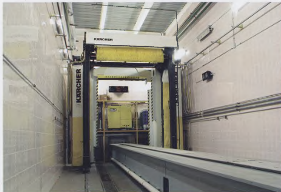
Моющая установка для подвижного состава
