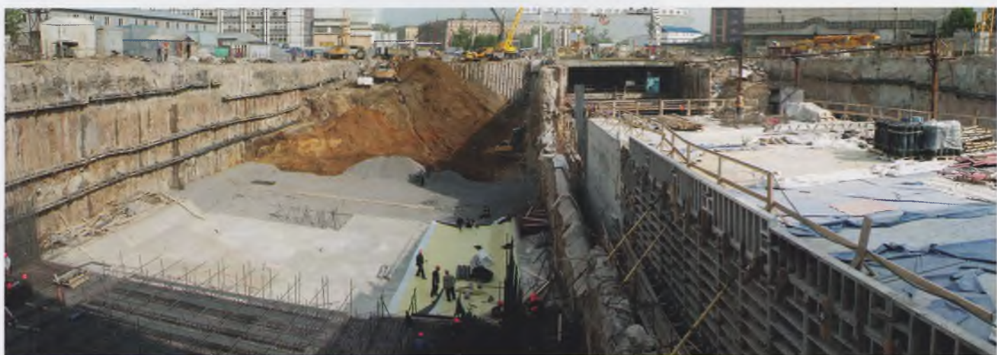
Рис. 6. Точка «В». Базовая стройплощадка. Сооружение тоннелей обоих направлений. Справа – участок ООО «Организатор», слева – Москапстрой, май 2003 г.
