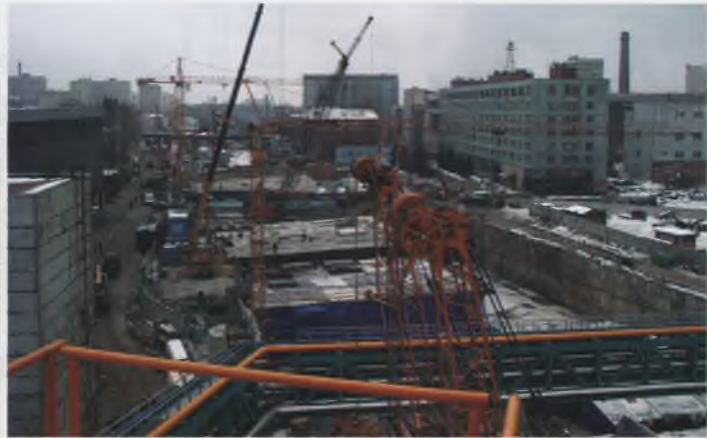
Рис. 5. Точка «В». Стройплощадка между базовой и ш. Энтузиастов. Вид с северной эстакады, январь 2003 г.
