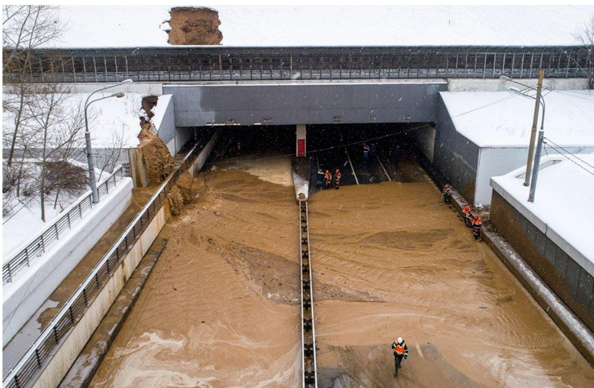
Рис. 3. Последствия разрушения глиняного замка канала им. Москвы с затоплением участка Волоколамского тоннеля
