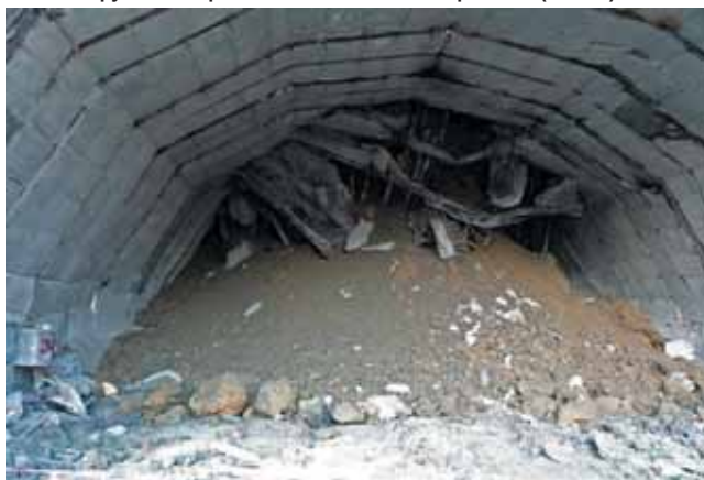
Рис. 2. Обрушение строящегося тоннеля в г. Нараянпет (Индия) в 2019 г.
