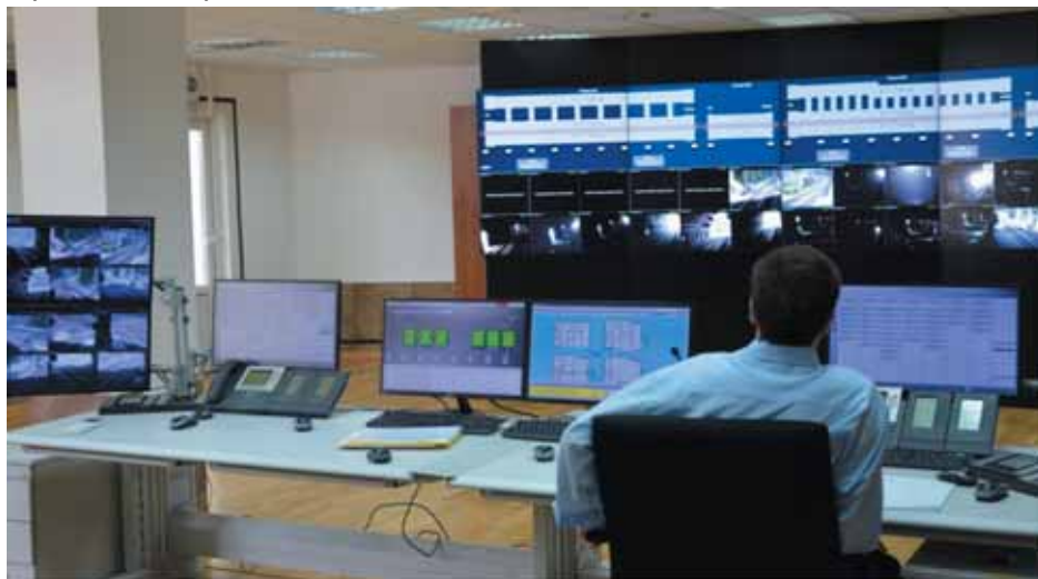
Рис. 3. Расположение отдельного автоматизированного рабочего места (АРМ) геотехнического мониторинга в диспетчерской
