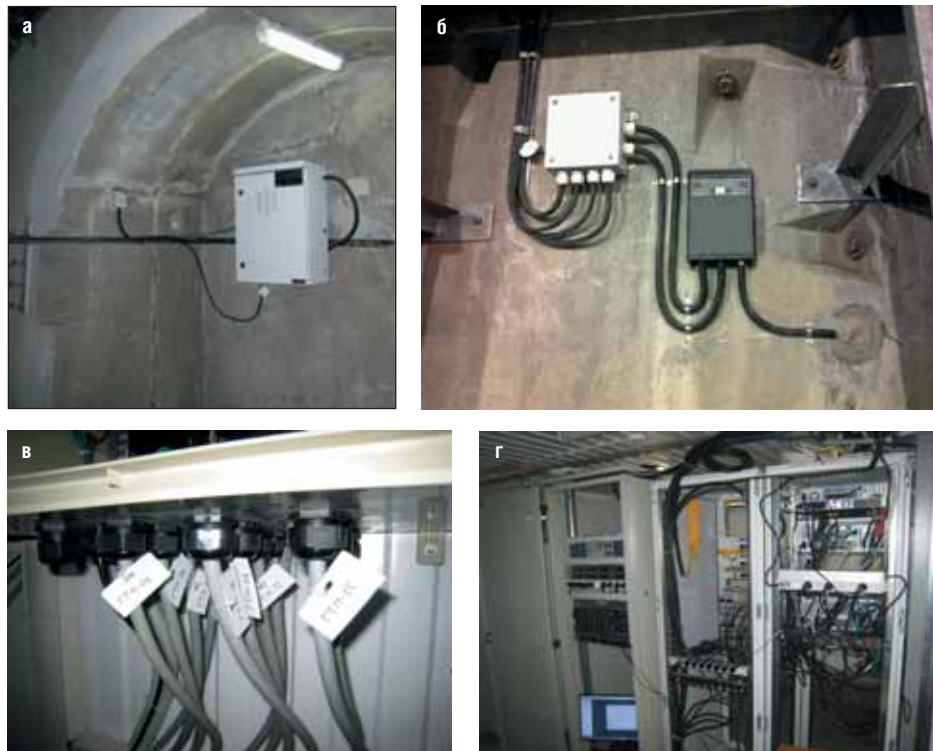
Рис. 2. Размещение и коммутация систем ГТМ в тоннелях трассы Адлер – Красная Поляна: а – внешний вид сейсмостанции, б – внешний вид блока регистрации и передачи информации аппаратуры ЕЭМИ, в, г – коммутация систем ГТМ
