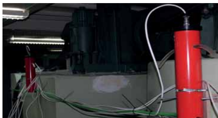
Рис. 5. Датчики гидростатического нивелирования, установленные на фундаменте центрифуги
