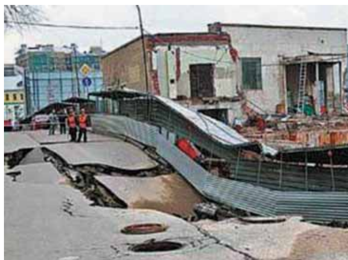
Рис. 2. Аварии при строительстве многофункциональных комплексов на Ленинградском проспекте (2006 г.) и Трубной площади (2007 г.)
