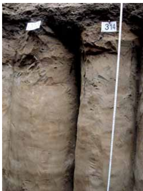
Рис. 4. Пример расхождения грунтоцементных колонн при устройстве ограждения котлована
