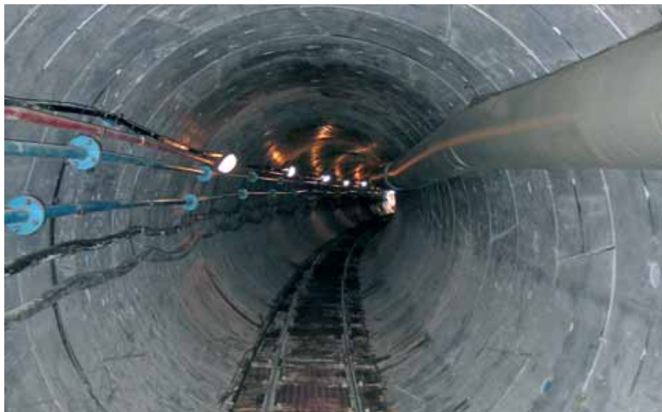
Коллектор со сборной обделкой из железобетонных блоков высокой точности изготовления
