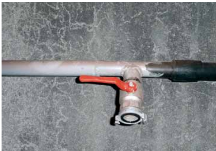
Рис. 2. Водопровод из полиэтилена для промывки венткамер
