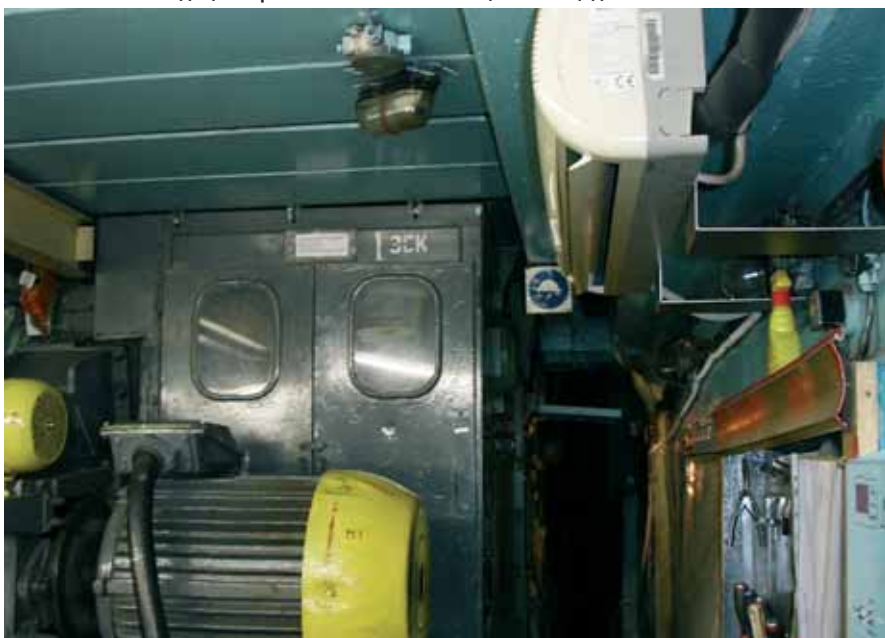
Рис. 5. Система кондиционирования в машзале станции «Площадь Ленина-1»
