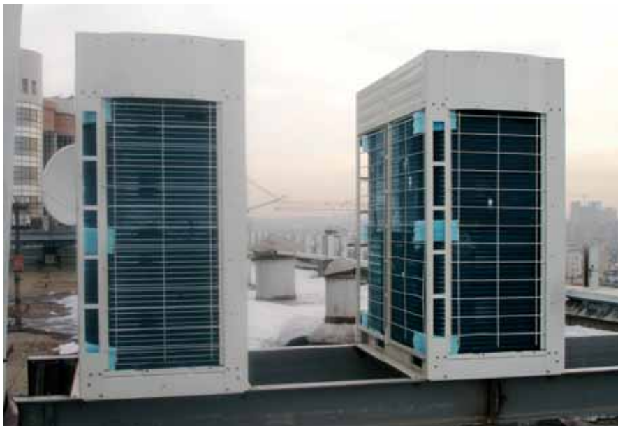
Рис. 4. Кондиционеры KENTATSU на крыше инженерного корпуса
