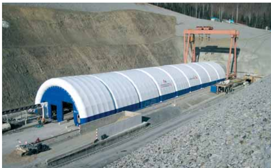
Бескаркасный тепловой контур над ТПМК Lovat RME-375SE
