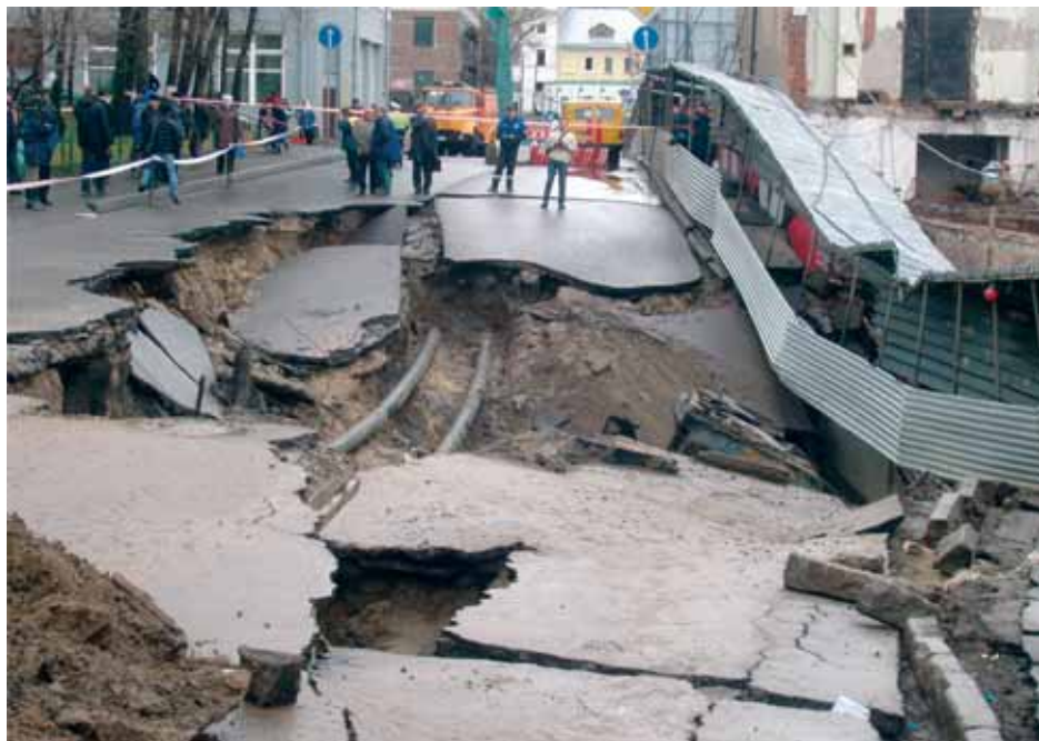
Рис. 1. Провал дорожного полотна на ул. Трубная в Москве
