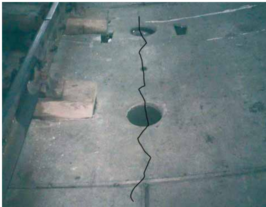
Рис. 9. Трещина посередине блока на всю его ширину образуется вследствие неточности монтажа, при наличии выступа в передней плоскости кольца свыше 1,2 мм даже при давлении домкратной пары 130 бар
