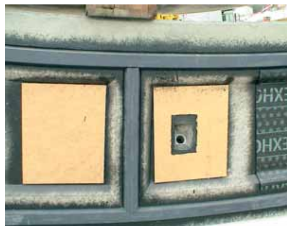
Рис. 5. Зазор между перемычкой и внутренним уплотнительным контуром, способствующий распространению воды через межблочное пространство по обделке
