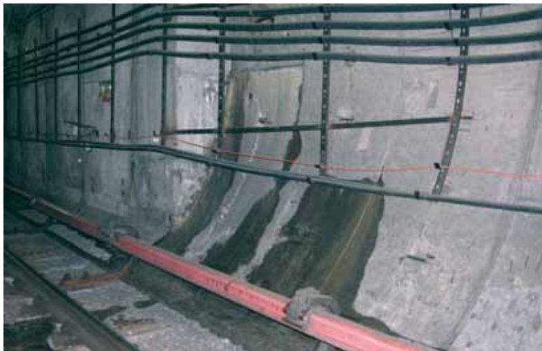
Рис. 2. Течи через стыки, монтажные отверстия и трещины в блоках обделки метрополитена
