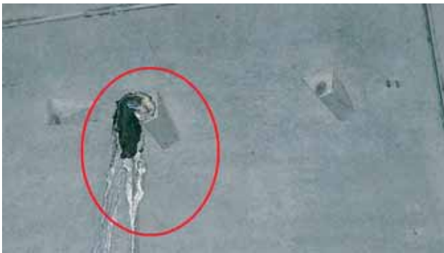
Рис. 8. Последствия установки в монтажное отверстие бракованных фиброцементных конусов – водопроявления из заделанных монтажных отверстий
