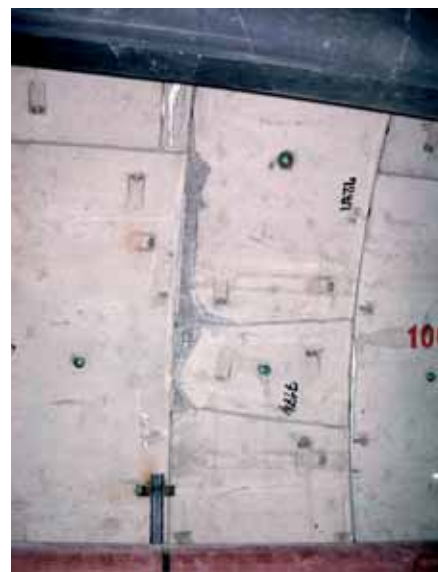
Рис. 10. Сколы бетона блоков обделки при неравномерном воздействии щитовых домкратов и наличии межкольцевых уступов
