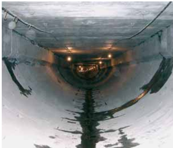
Рис. 3. Течи из-под опор плиты перекрытия в тоннеле
