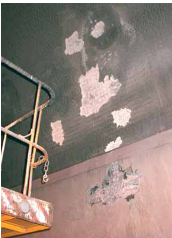
Рис. 1. Характер водопроявления в тоннеле через огнезащитное покрытие с его отслоением и разрушением
