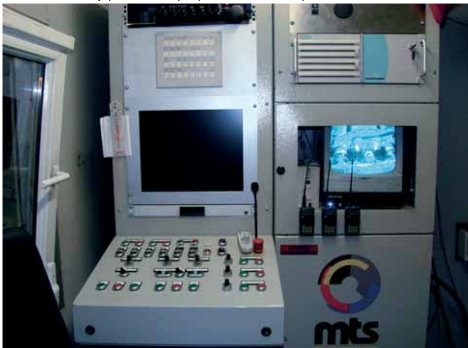
Рис. 1. Главный пост управления в операторском отсеке контейнера
