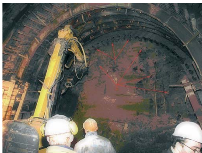
Рис. 3. Проходка подходной выработки с опережающим креплением кровли и лба забоя в протерозойских глинах: 1 – опережающая крепь кровли; 2 – опережающая крепь лба забоя
