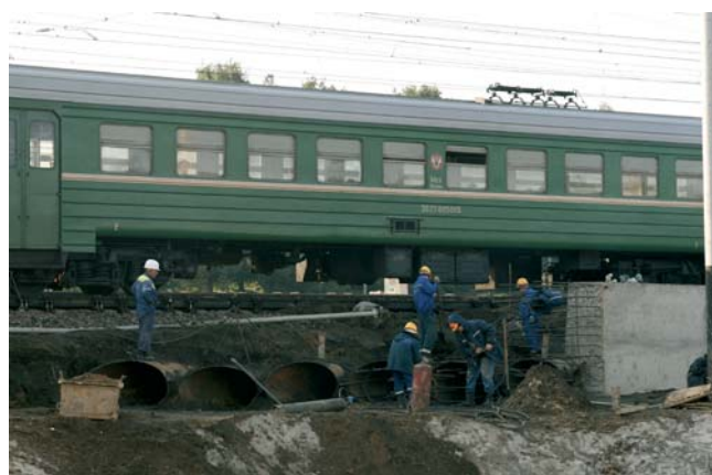
Перед началом проходки под действующими железнодорожными путями специалисты СМУ-5 соорудили защитный экран
