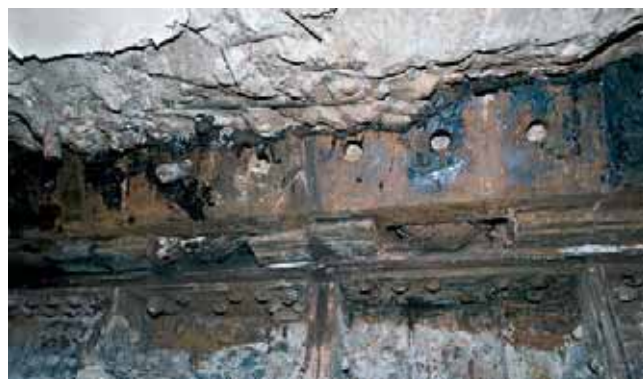
Состояние фрагмента металлической обделки свода, освобожденной от бетона при реконструкции станции
