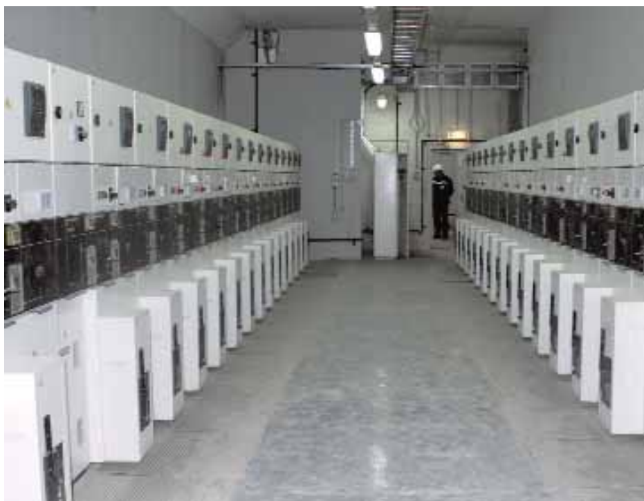
Распределительная трансформаторная подстанция (РТП)
