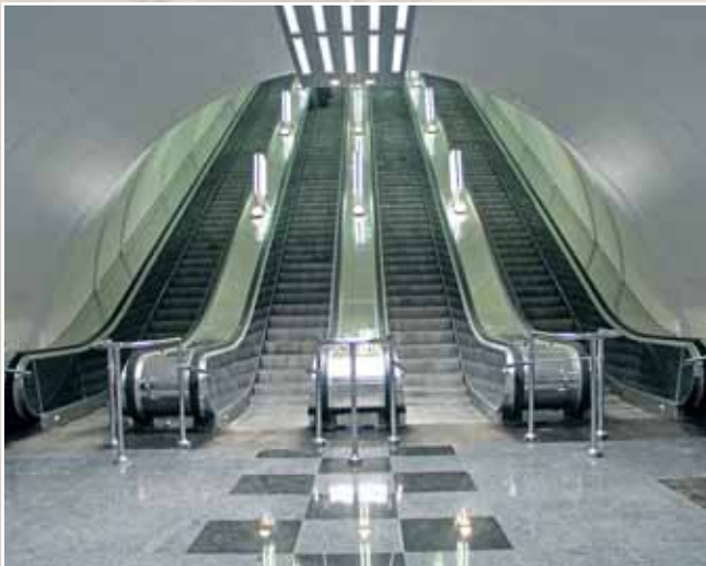
Тоннельный эскалатор ЕТК-245 (высота подъема от 15.1 до 45 метров)
