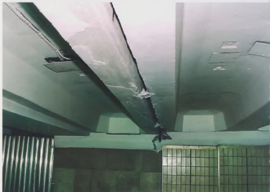
Рис. 3. Смещение балок и плит перекрытия в пешеходном переходе ст. «Ленинский проспект»
