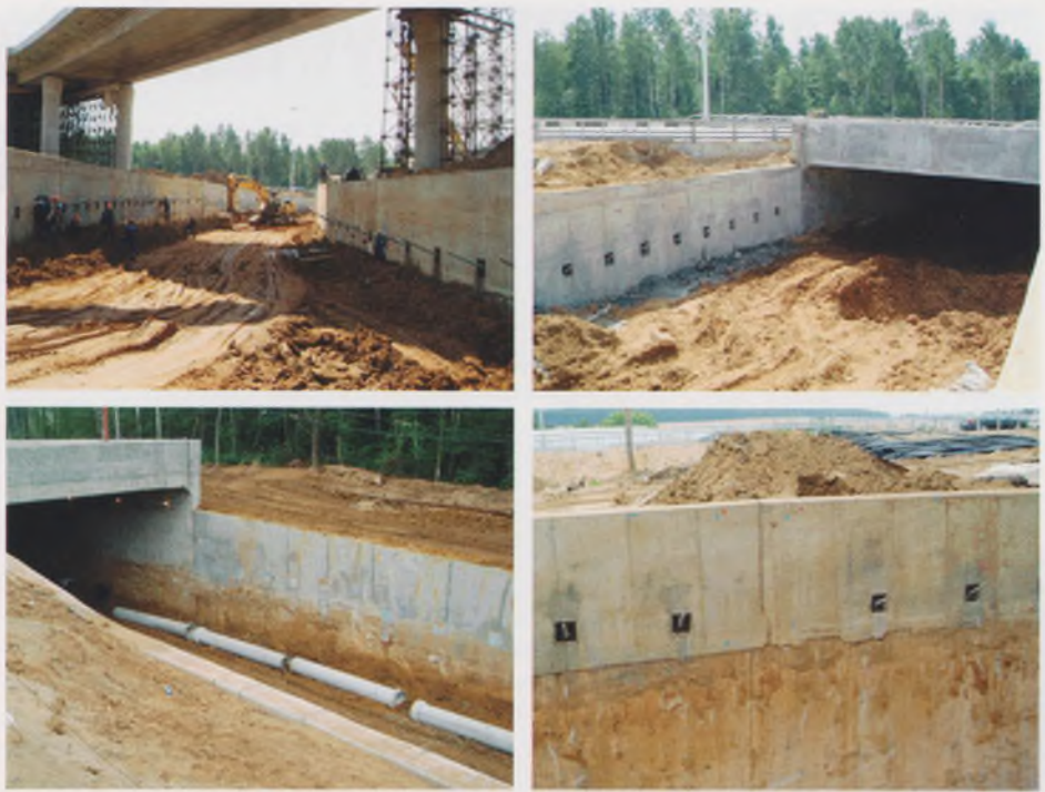
Рис. 6. Применение анкерных свай для крепления подпорных стенок путепровода тоннельного типа при реконструкции Киевского шоссе в районе съезда № 3
