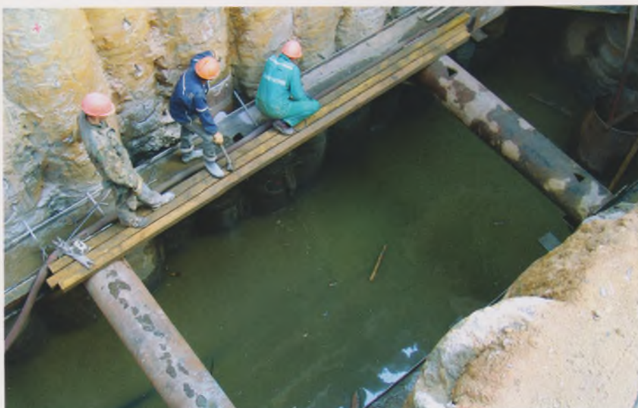
Рис. 6. Затопленное притоннельное сооружение
