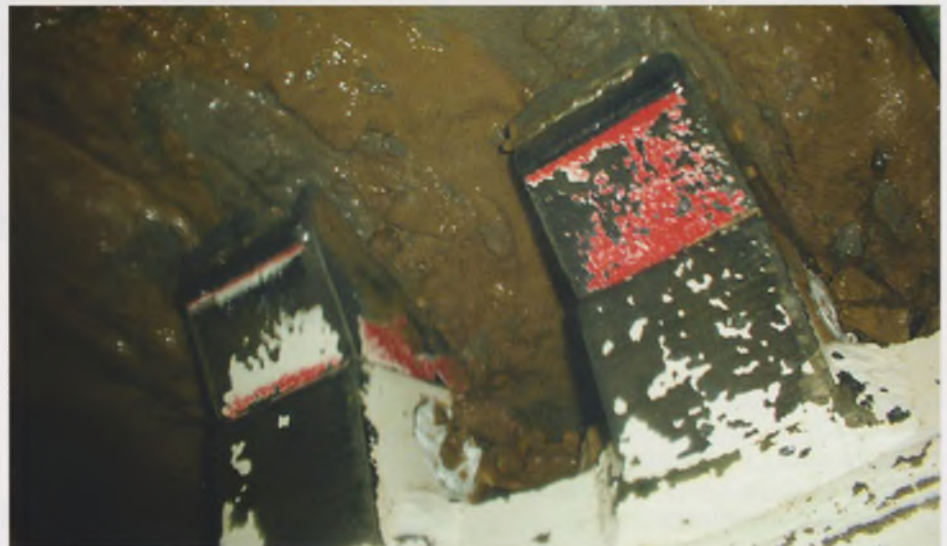
Состояние резцов ротора в забое
