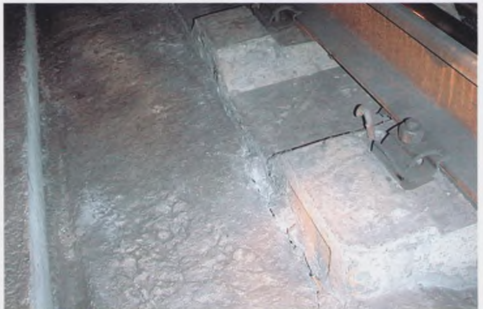
Рис. 4. Усадочные трещины по «холодному» шву вокруг лежней
