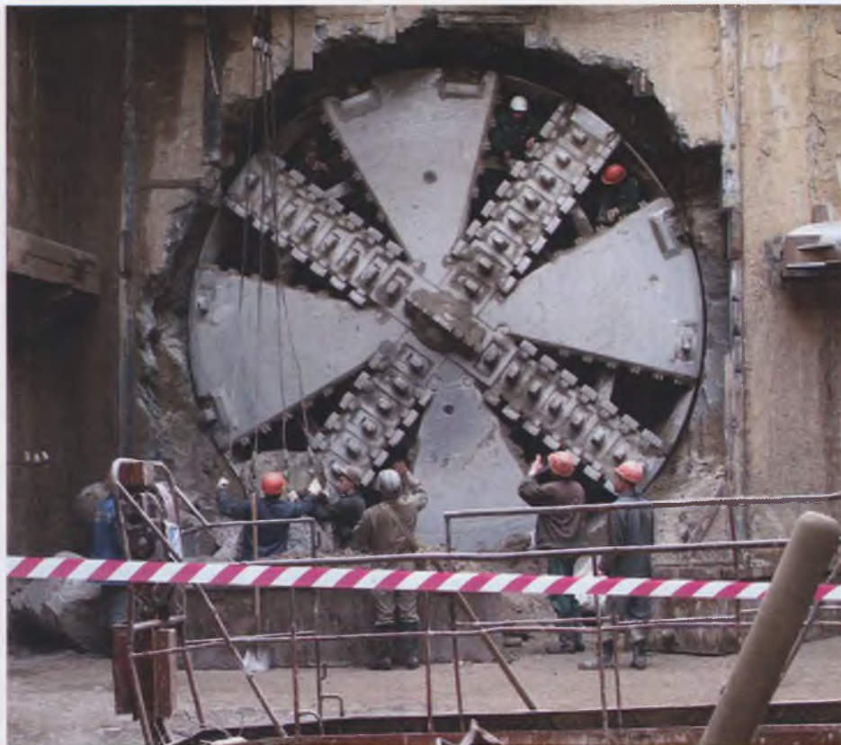
Щит фирмы «Ловат» с грунтовым пригрузом. Прошел два тоннеля на Бутовской линии Московского метрополитена
