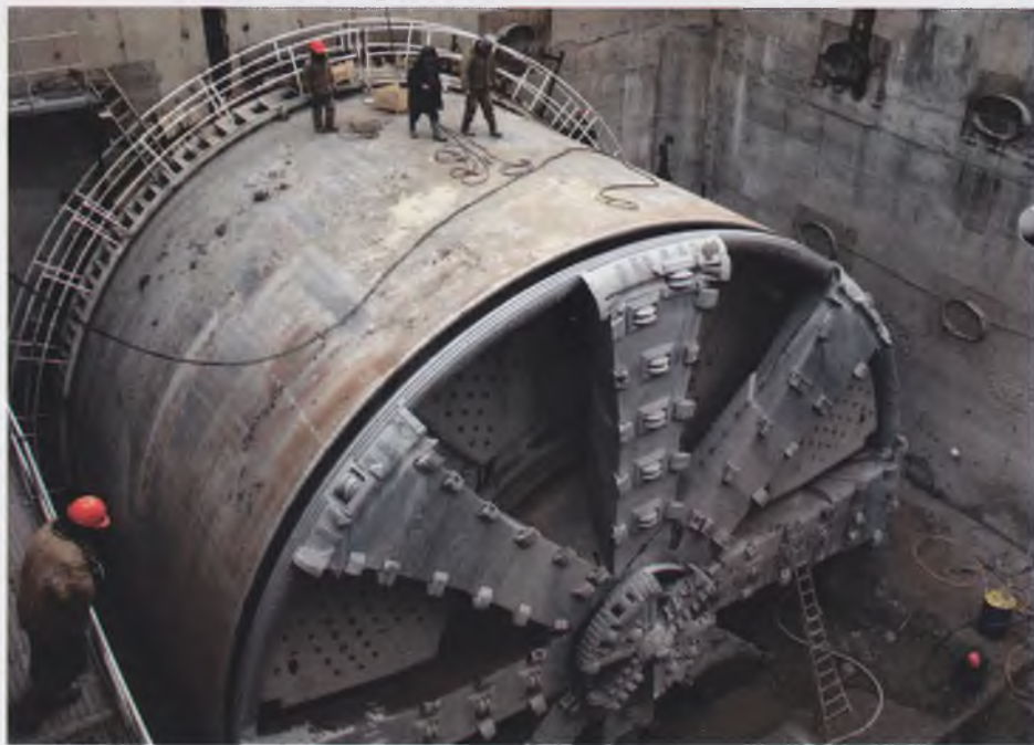
ТПМК фирмы «Херренкнехт АГ» в демонтажной камере после завершения проходки Лефортовского тоннеля
