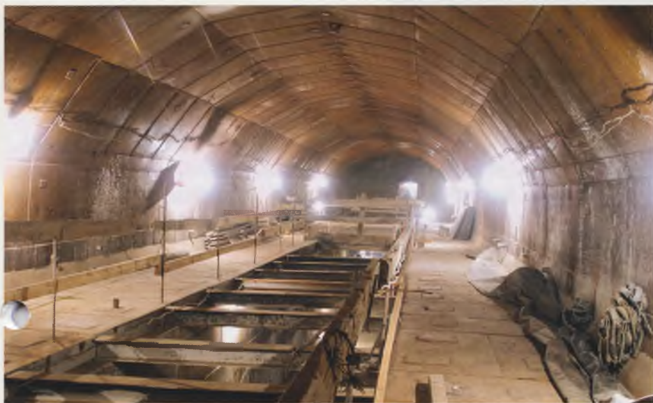
Сводчатая часть понизительной подстанции
