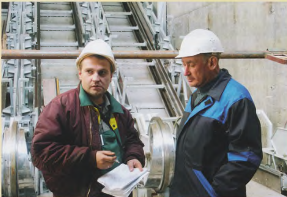
Зам. начальника участка №5 Т. В. Колесов и механик Ю. И. Дюков. Монтажные работы на станции «Адмирала Ушакова»
