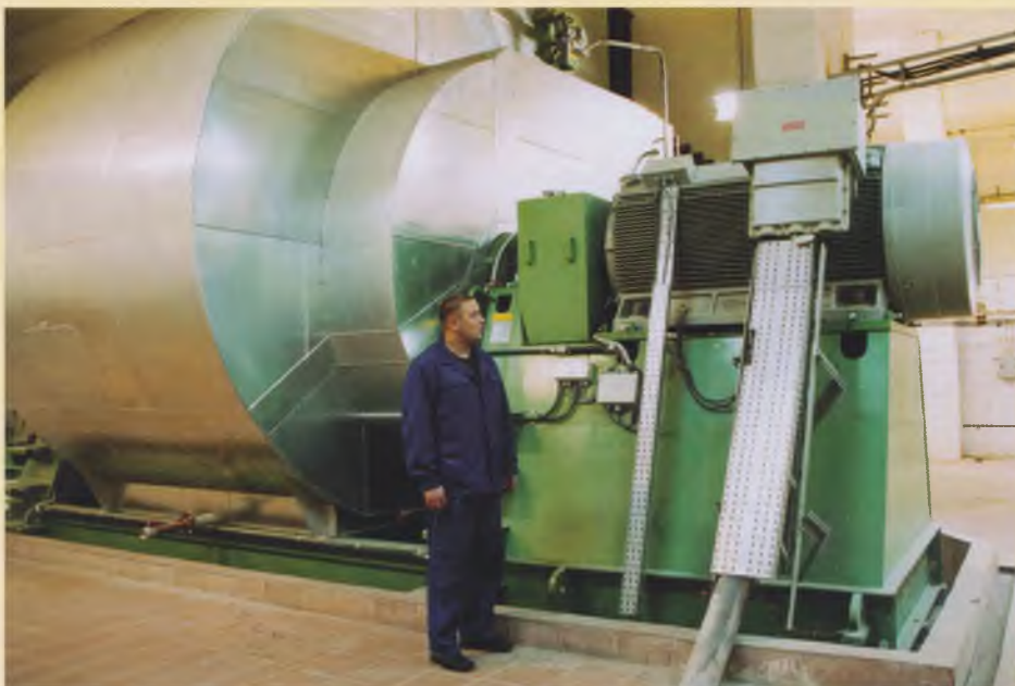
Вентиляционная камера Гагаринского тоннеля. Электродвигатель вентилятора мощностью 1 тыс. кВт
