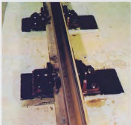
Рис. 5. Опоры, установленные в перегонном тоннеле
