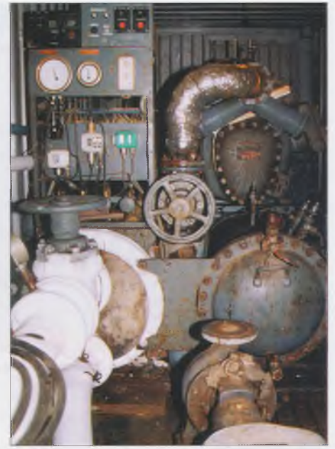
Рис. 3. Внутреннее устройство установки ПХУ-50
