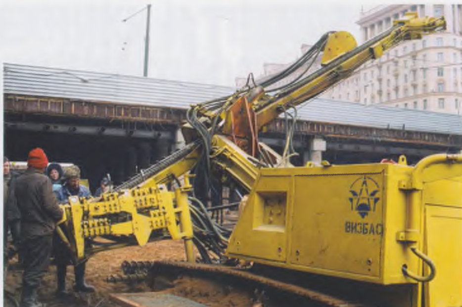
Установка УБВ-06 («Бауэр»). Устройство грунтовых анкеров на Кузювской развязке 3-го транспортного кольца в Москве
