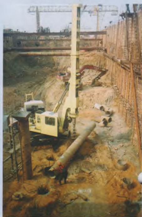
Устройство буронабивных свай в основании платформенного участка станции Минского метро «Каменная Горка», 2002 г.
